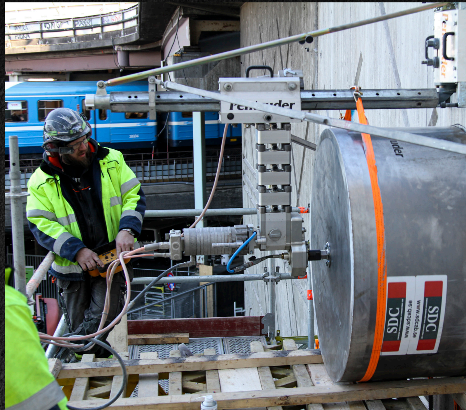
SDCAB Borrkrona, B22, DIM 1250 och Pentruder väggsågsmotor med borrhingsadapter på Slussenprojektet i mars 2019.
